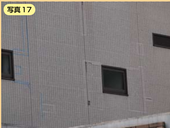
秋保温泉 ホテル瑞鳳 別館タイル仕上げ壁面の剥離
