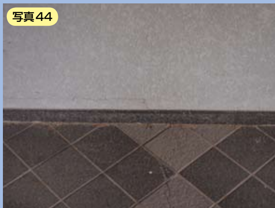
国際交流センター 床・壁に亀裂が入っている
