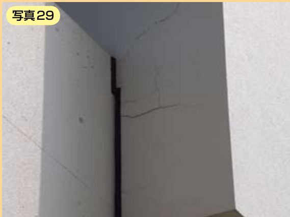
本塩釜駅 外壁コーナーパネルに亀裂拡大
