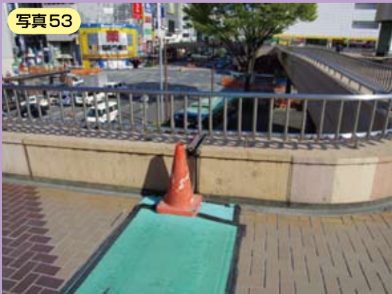
仙台駅前ペデ エキスパンション部の状況
