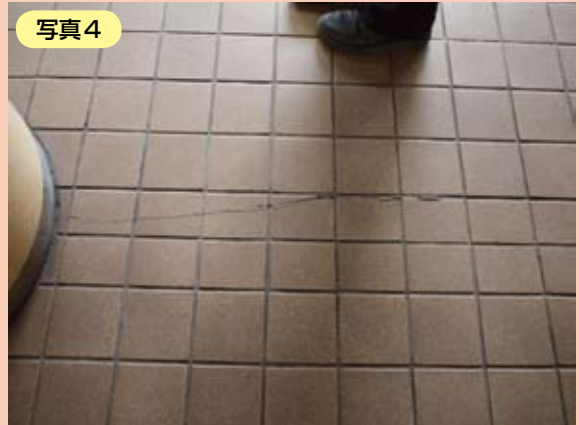
仙台市地下鉄 南北線 旭ヶ丘駅ホーム階 プラットホーム亀裂
