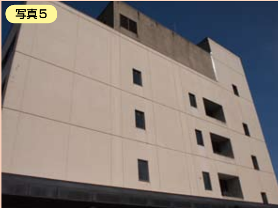
仙台市地下鉄 南北線 旭ヶ丘駅地上駅舎 亀裂
