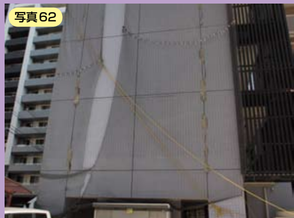
タイルの脱落
