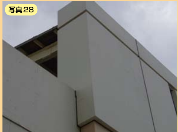
本塩釜駅 外壁コーナーパネルに亀裂発生
