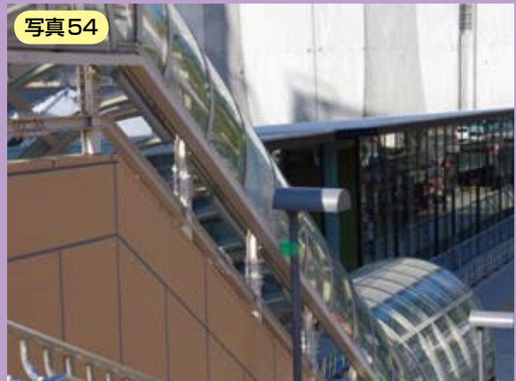
仙台駅前ペデ 周囲部材の破損例
