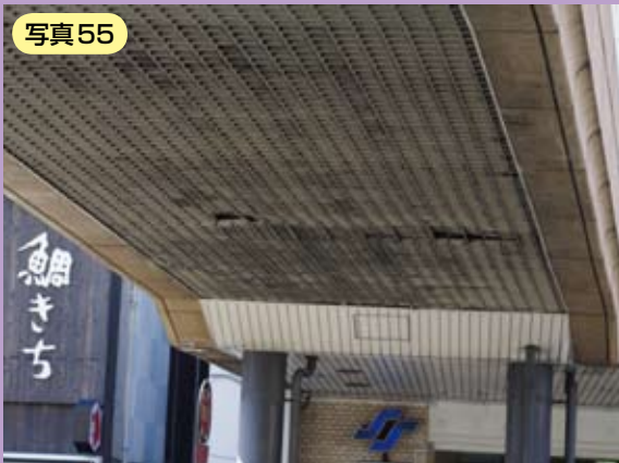
仙台駅前ペデ 裏面金属部材の変形
