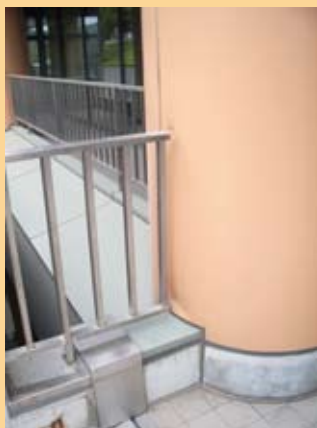
東北大学 電波吸収 GRC パネル エキスパンション部材同士の干渉
