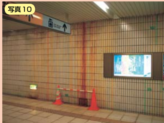
仙台市地下鉄 南北線 愛宕橋駅改札階 漏水
