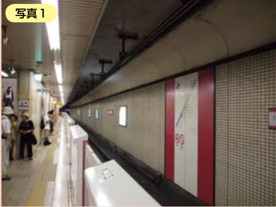
仙台市地下鉄 南北線 台原駅ホーム階 対向壁 R 付き GRC パネル
