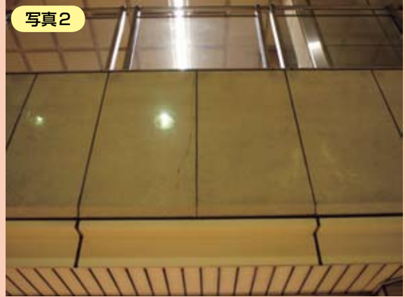
仙台市地下鉄 南北線 台原駅改札階 内装材クラック
