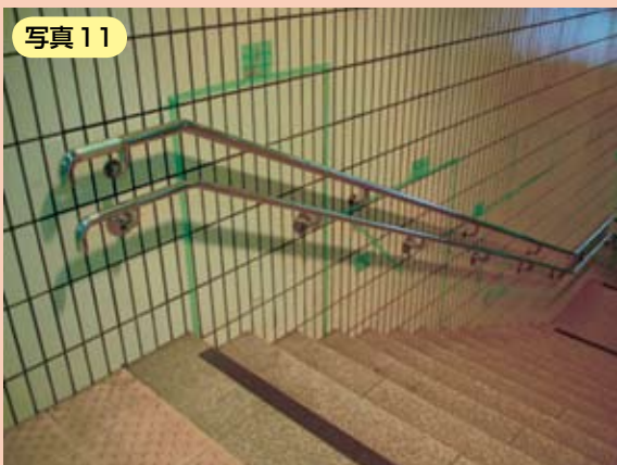
仙台市地下鉄 南北線 愛宕橋駅ホーム階-改札階 階段内装タイルクラック・浮き
