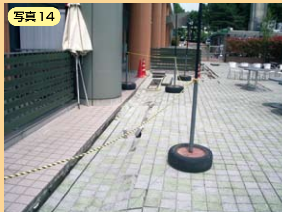
東北大学 電波吸収 GRC パネル 地盤面陥没
