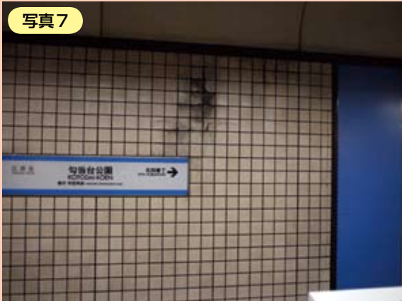
仙台市地下鉄 南北線 勾当台公園駅ホーム階 対向壁クラック
